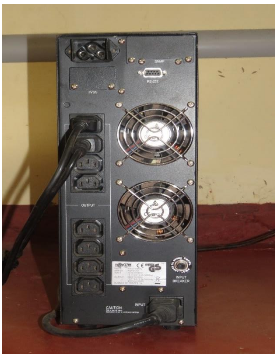
Fig. 8 Vista posterior del Equipo UPS
